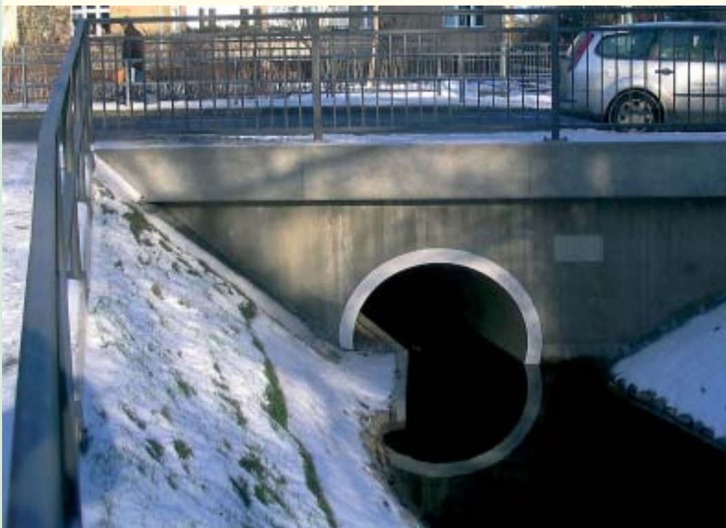
Am Schafgraben hilft ein eigener Steg Ottern und Bibern, trockenen Fußes – und vor allem vor dem Verkehr geschützt – eine Straße zu unterqueren
